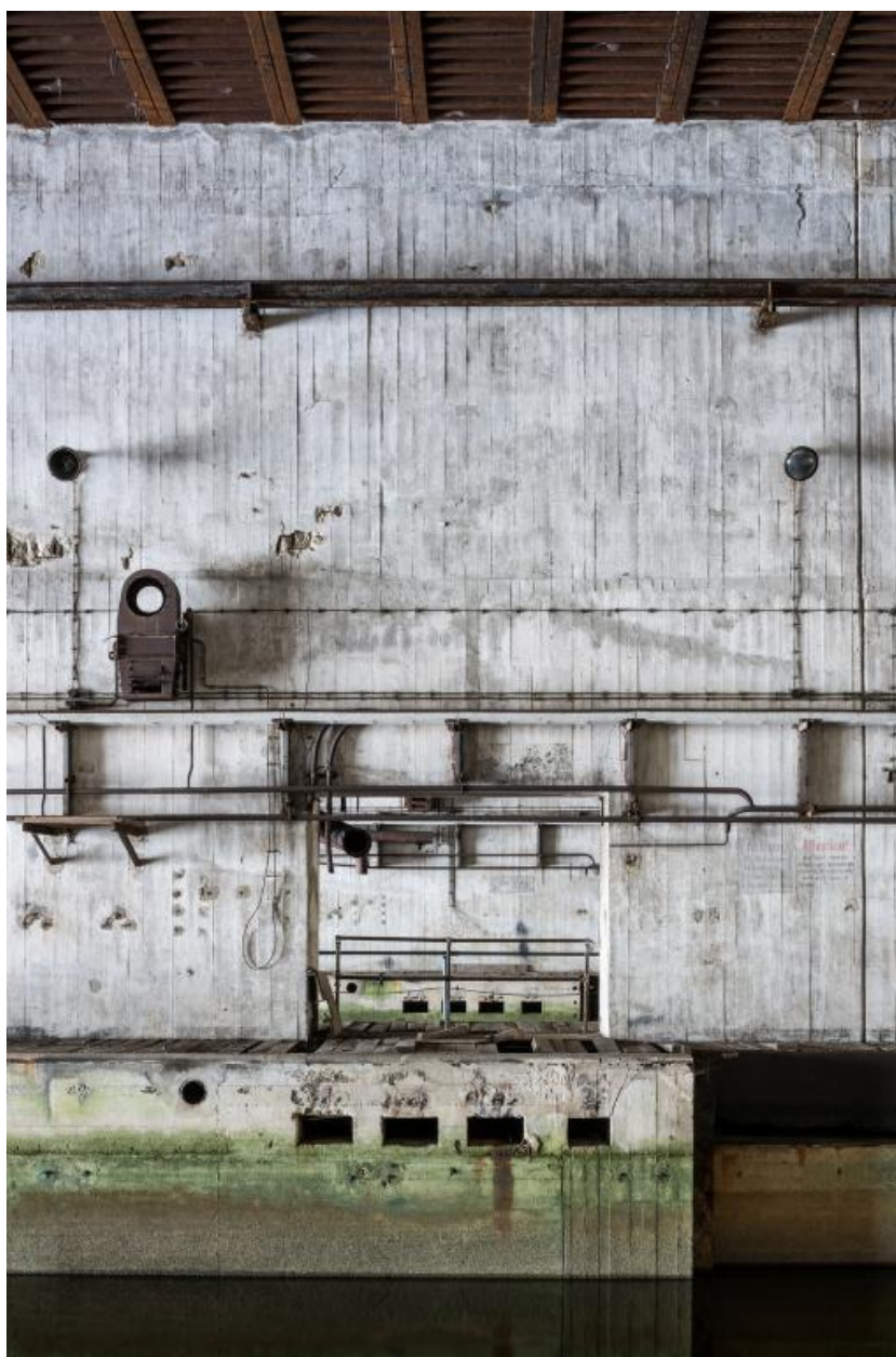
Vue de l'alvéole sud : emplacement de l'un des postes d'amarrage flottant. Sur le mur, système de chauffage et de ventilation et chemin de câble
