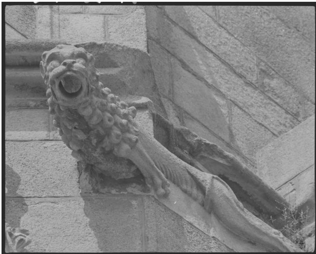
Gargouille, façade sud
