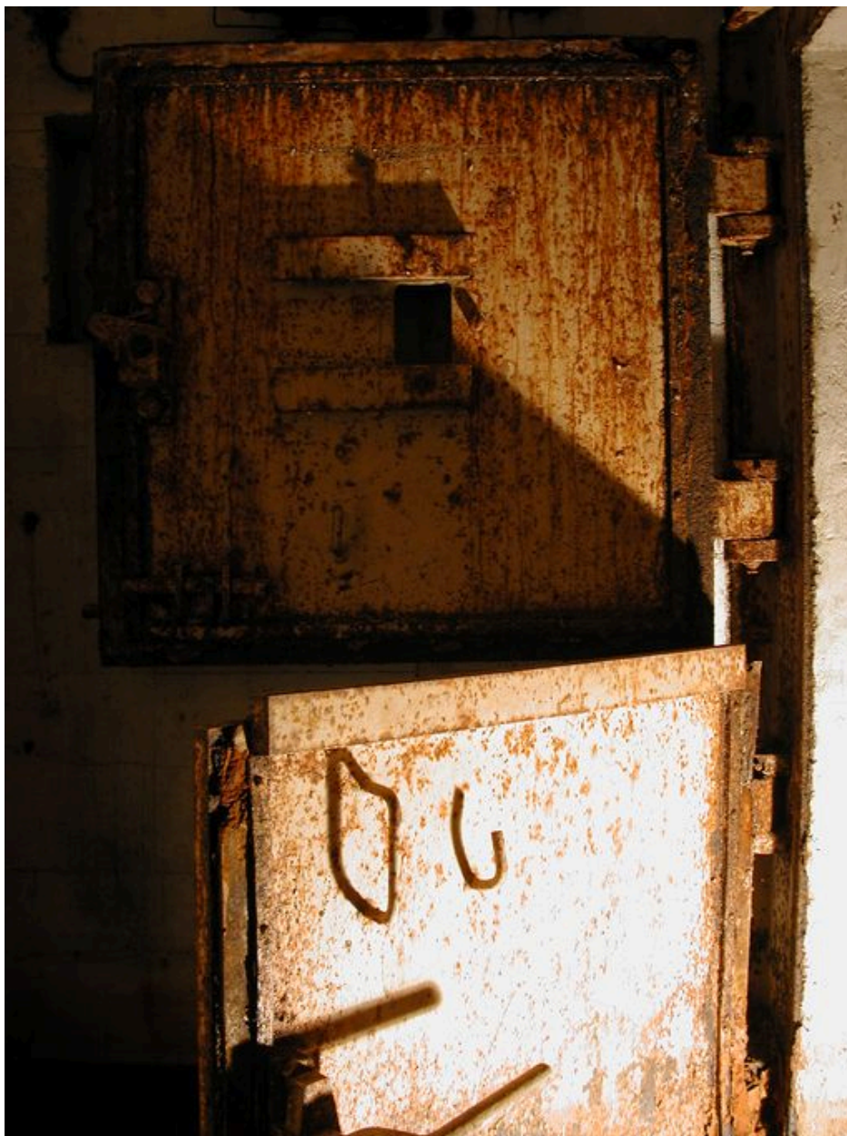
Vue de la porte blindée à deux vantaux de type 434P01 du poste d'observation/petite pièce latérale
