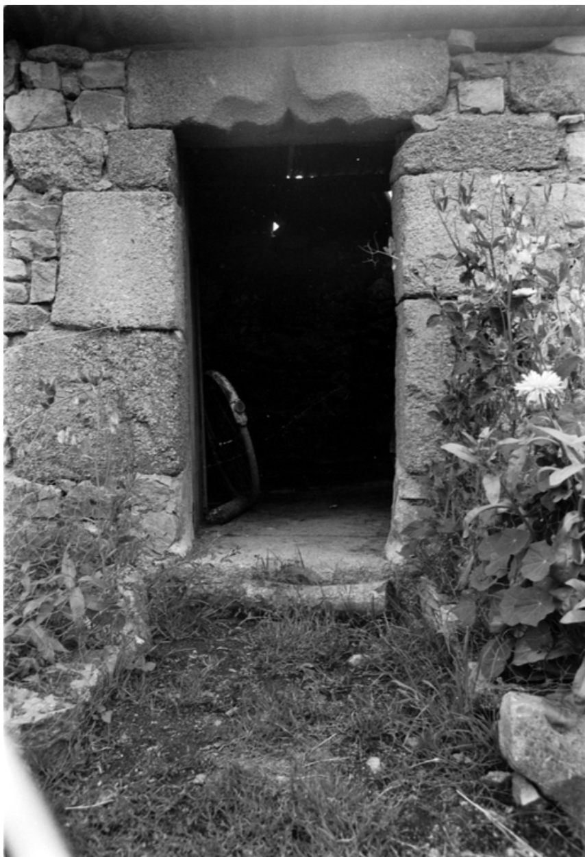
Maison (le Grand Faut) : maison en ruines, porte d'entrée
