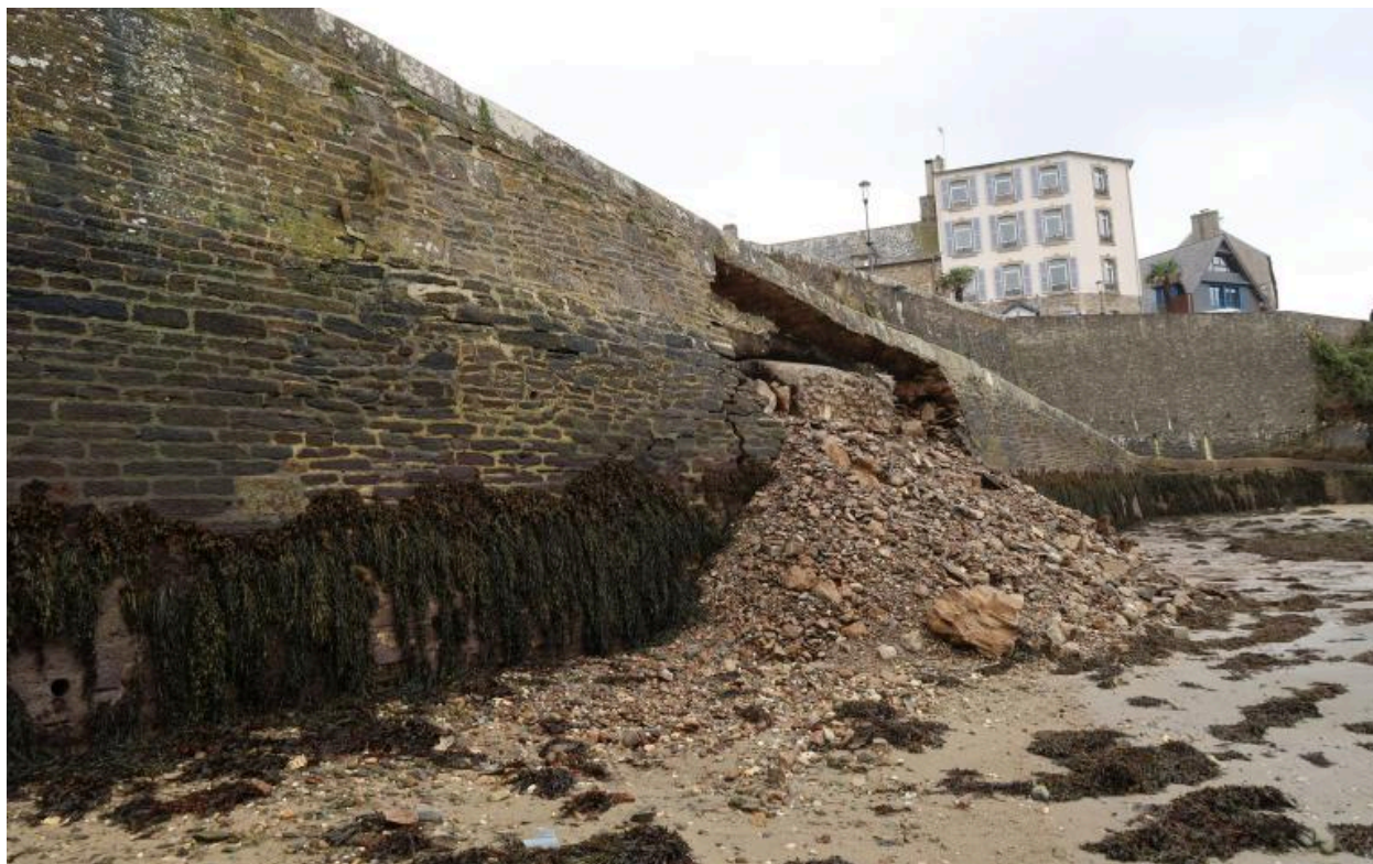
Vue rapprochée de l'effondrement de la cale
